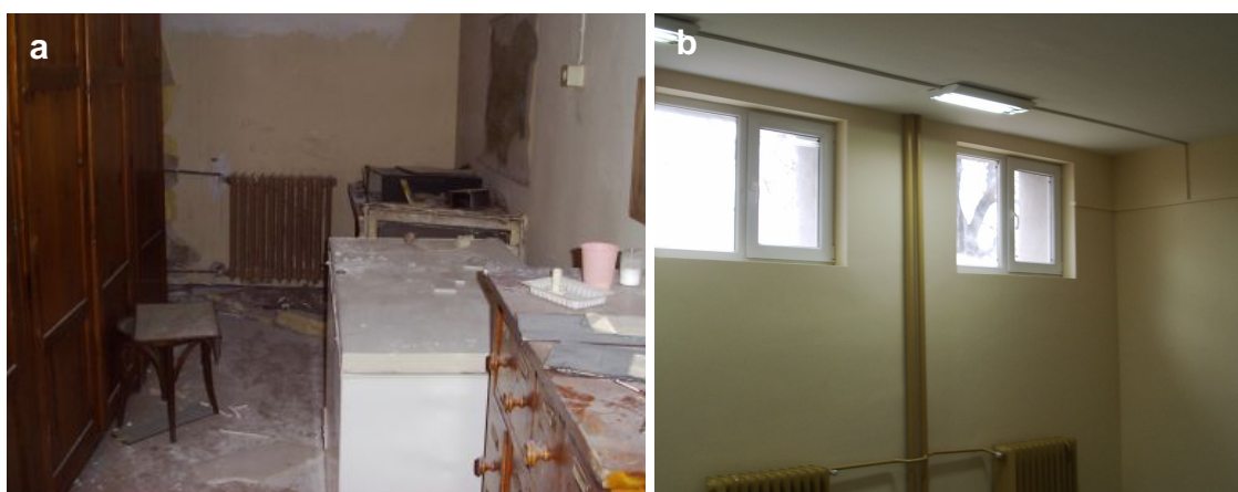
Фиг. 6. Работни условия в зала III преди (а) и след (б) ремонта
